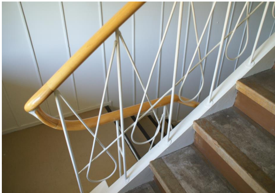
Kuva: Pääporrashuone. Lepotasollinen suoravartinen portaikko, jonka kaiteessa on puinen lakattu käsijohde ja pystypinnat kapeasta teräsputkesta silmukakoristeluin.
